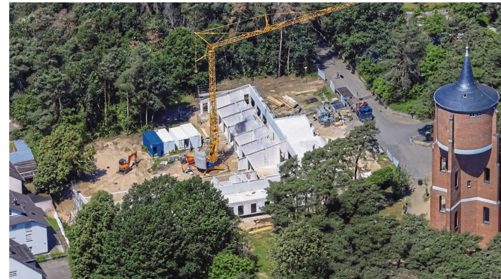
Die Baustelle neben dem Jügesheimer Wasserturm aus der Vogelperspektive: Drei Wochen früher als geplant steht der Rohbau.
